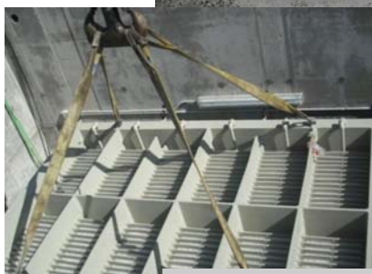
Detalle de Instalación
